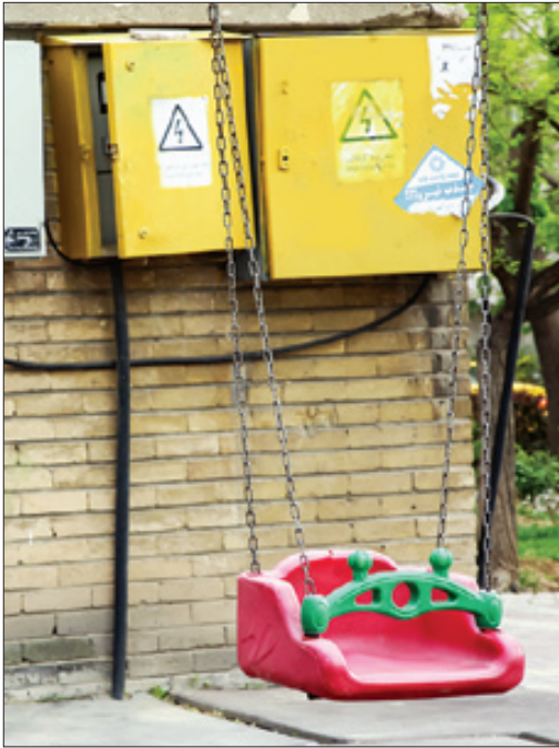
بکس برق روی دیوار محوطه بازی کودکان آنها را در معرض خطر برق گرفتگی قرار داده است
